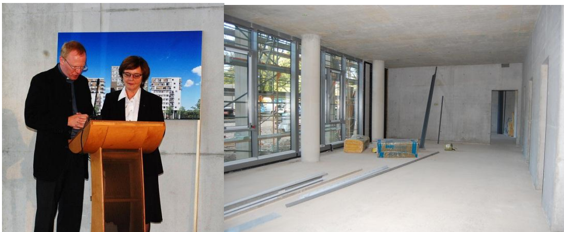
Im südlichen Turm der drei Gebäude der „Marsilius-Arkaden“ entsteht das Ökumenische Zentrum (re). Beim Richtfest gaben Dekanin Schwöbel-Hug und der katholische Pfarrer Johannes Brandt den Segen für den Neubau (li).
